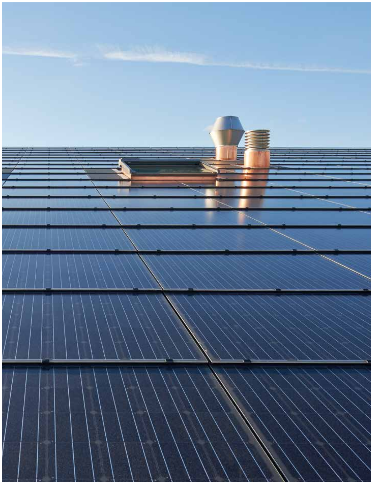
Photovoltaikanlage in die Dachfläche integriert, Eternit Österreich GmbH © Jürg Zimmermann, Zürich
